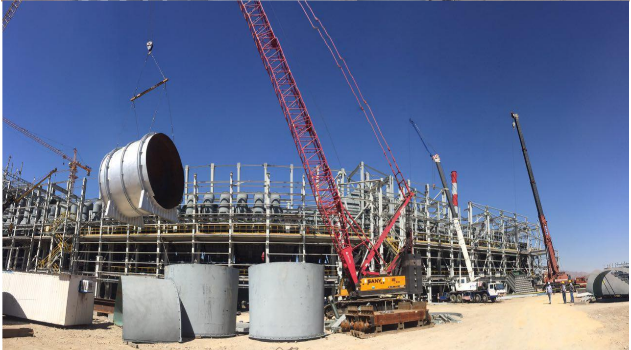
نصب کوره و هود (Indurating Machine)
